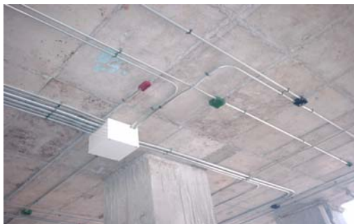
รูปแสดงการติดตั้งเดินท่อร้อยสายต้องยึดกับที่ให้มีมั่นคง
