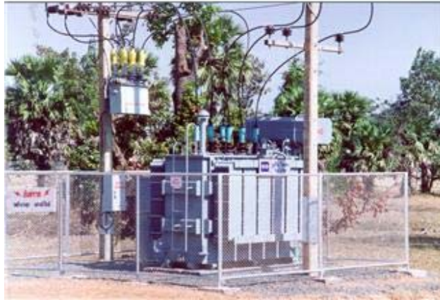
รูปแสดงหม้อแปลงแรงดันชนิดใช้ภายนอกอาคาร
