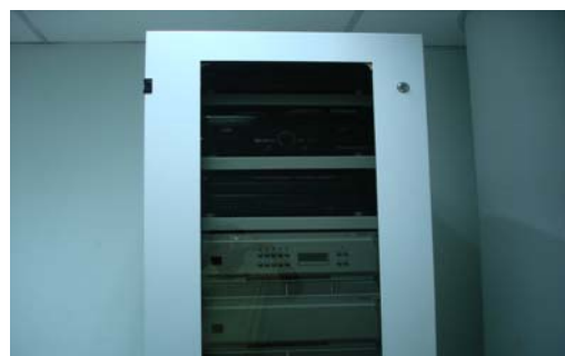
รูปตู้อุปกรณ์ระบบเสียง
