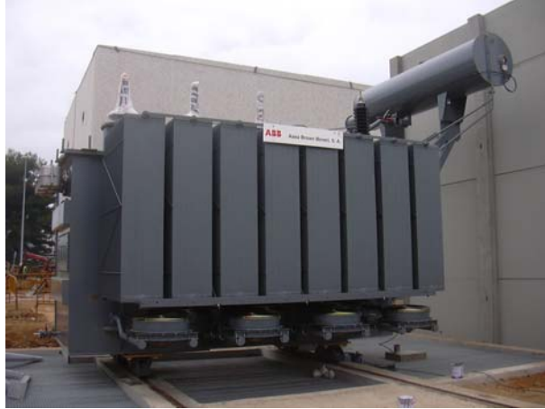
รูปหม้อแปลงชนิดน้ำมัน
