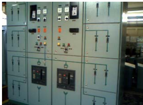
รูปแสดงตู้อุปกรณ์ควบคุมไฟฟ้า
