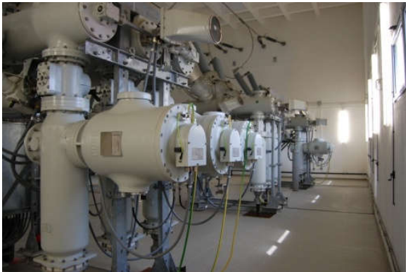
รูป INDOOR SUBSTATION
