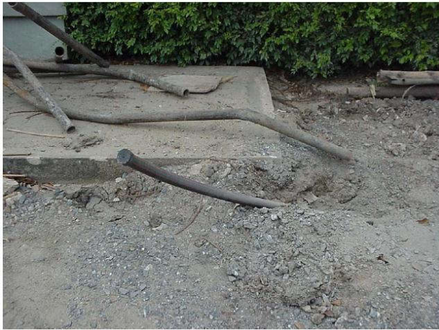
การตรวจสอบระบบไฟฟ้าเบื้องต้น เรียบเรียงโดย อ.มนตรี เชาวเดช
