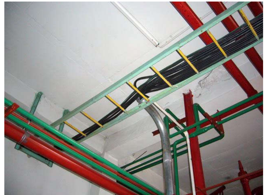
การตรวจสอบระบบไฟฟ้าเบื้องต้น เรียบเรียงโดย อ.มนตรี เจาเดช
