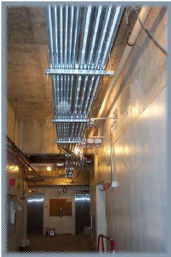
การตรวจสอบระบบไฟฟ้าเบื้องต้น เรียบเรียงโดย อ.มนตรี เจาเดช
