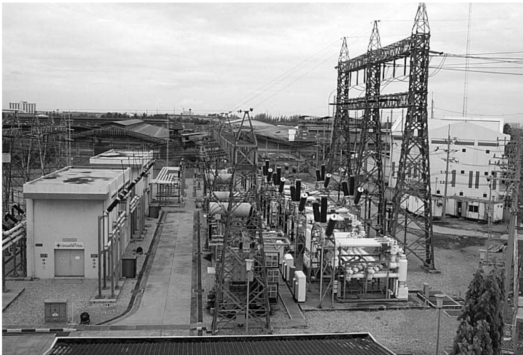
รูปที่ 1 สถานีไฟฟ้าแรงสูง GIS แบบภายนอกอาคารและภายในอาคาร
