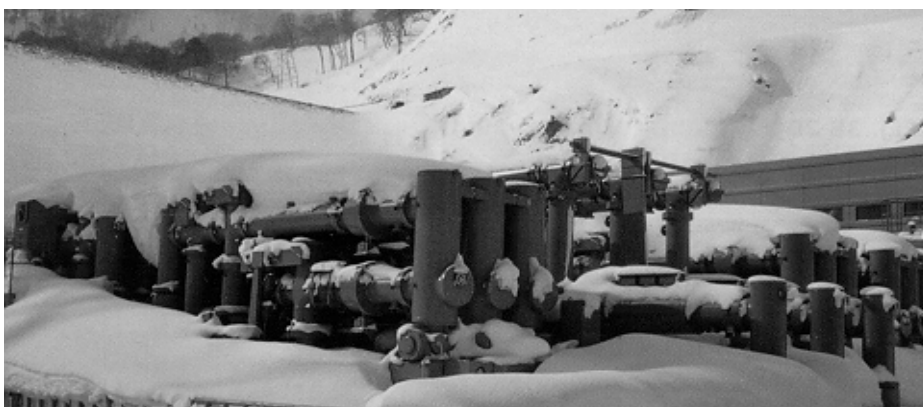
รูปที่ 4 ตัวอย่าง GIS ติดตั้งในพื้นที่มีหิมะปกคลุม
