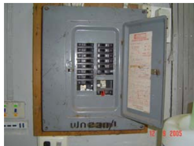
รูปที่ 7-15 Circuit Breaker
